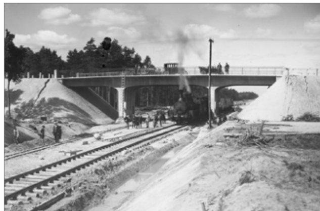
Budowa magistrali kolejowej Śląsk–Gdynia na odcinku Herby–Kalety. Widoczny wiadukt szosy Częstochowa–Lubliniec nad linią kolejową NAC
